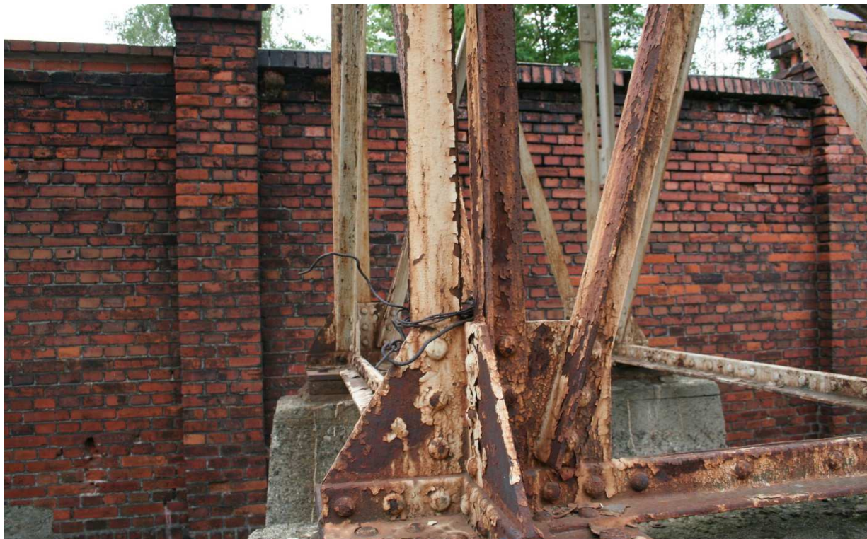
Zdjęcie nr 25. Kładka we Wrocławiu pomiędzy ulicami Robotniczą i Tęczową. Kratownicowe dźwigary w złym stanie technicznym. Na wszystkich elementach prawie całkowicie zniszczone antykorozyjne powłoki malarskie, zaawansowana korozja powierzchniowa oraz ogniska korozi wżerowej.
