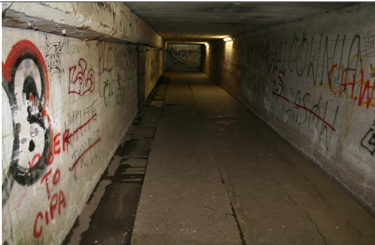
Zdjęcie nr 36. Czechowice - Dziedzice, przejście podziemne pomiędzy ulicami Kolejową i Hutniczą. Odspojenie powłok malarskich ścian. Ściany zanieczyszczone przez graffiti. Betonowa nawierzchnia chodnika z licznymi pęknięciami i ubytkami betonu,
