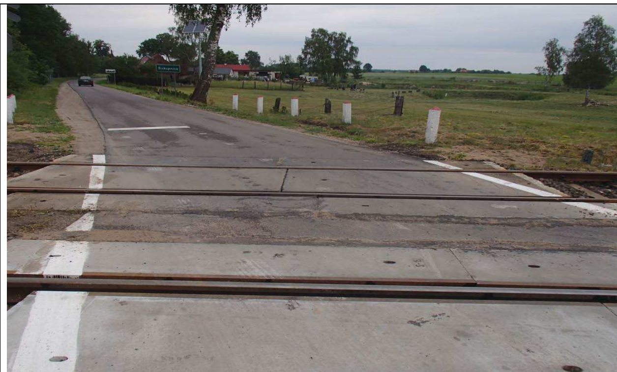
Zdjęcie nr 1. Chojnice – Runowo, przejazd kat. D na linii 210, w km 25,355. Brak współpracy PKP PLK S.A. z zarządcą drogi. Przejazd nieoznakowany, niewłaściwe wyгородzenie słupkami prowadzącymi (pachołkami) z obu stron drogi na dojazdach do przejazdu. Nierówności na płytach przejazdowych.
