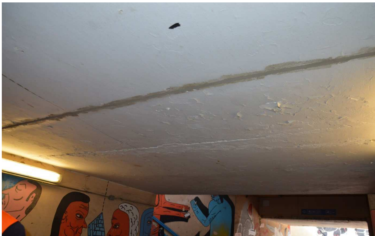
Zdjęcie nr 35. Przejście pod torami na stacji PKP Gdynia Grabówek. Zarysowania na konstrukcji obiektu, złuszczenia powłok malarskich na ścianach i suficie. Zły stan wizualno-estetyczny, graffiti.
