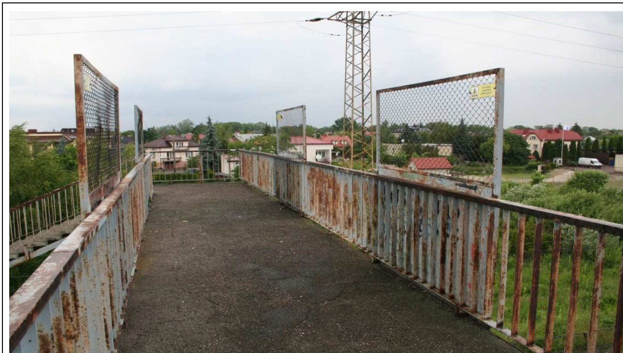
Zdjęcie nr 32. Błonie, kładka przy ul. Łąki. Zniszczona antykorozyjna powłoka malarska. Zawansowania korozji powierzchniowa, ogniska korozji wżerowej. Pęknięcia bitumicznej nawierzchni chodnika. Wszystkie osłony przeciwporażeniowe, za krótkie, tj. nie spełniały warunku aby pionowa krawędź osłony znajdowała się w odległości nie mniejszej niż 2 m od znajdującej się pod napięciem sieci trakcyjnej.
