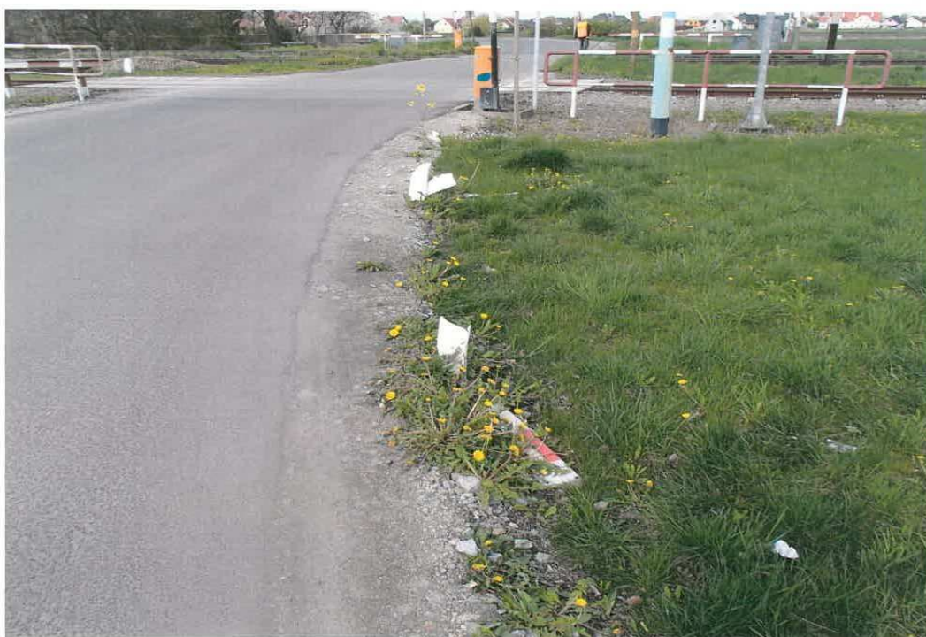
Zdjęcie nr 5. Przejazd kat. A w km. 14,087 linia nr 276. Zniszczone wygradzenie, połamane słupki ostrzegawcze.
