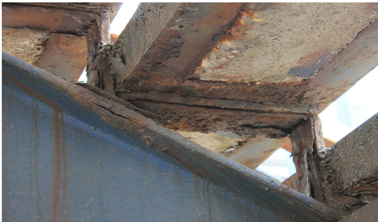
Zdjęcie nr 22. Kładka dla pieszych na stacji Łowicz, linia nr 3 w km. 80,670. Korozja wgłębną metalowej konstrukcji schodów. Kładka w trakcie modernizacji linii kolejowej Warszawa – Poznań ma ulec likwidacji (w latach 2017-2019 zaplanowano wybudowanie przejścia podziemnego).
