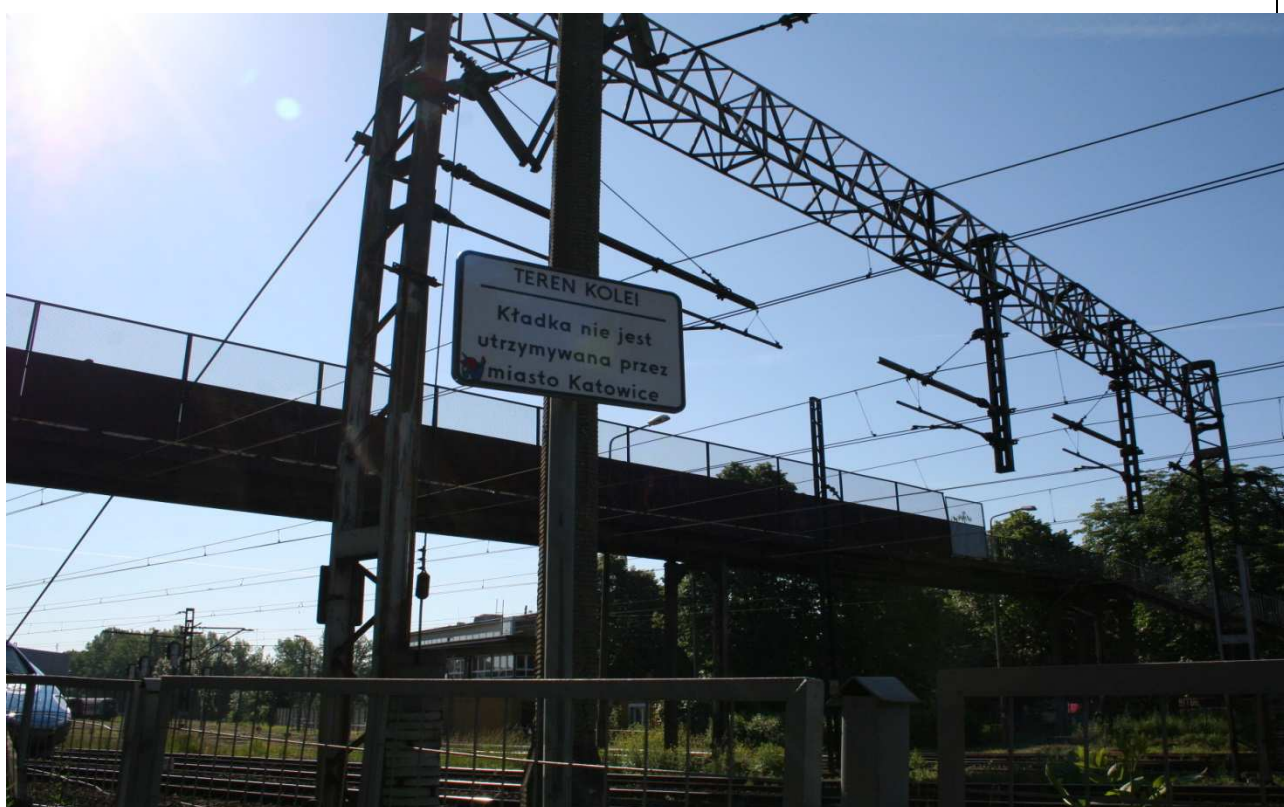
Zdjęcie nr 31. Katowice, kładka w ciągu ul. Paderewskiego. Obiekt ogólnie w złym stanie technicznym, wymaga pilnego remontu. Tablica informacyjna, iż UM w Katowicach nie jest zarządcą obiektu.
