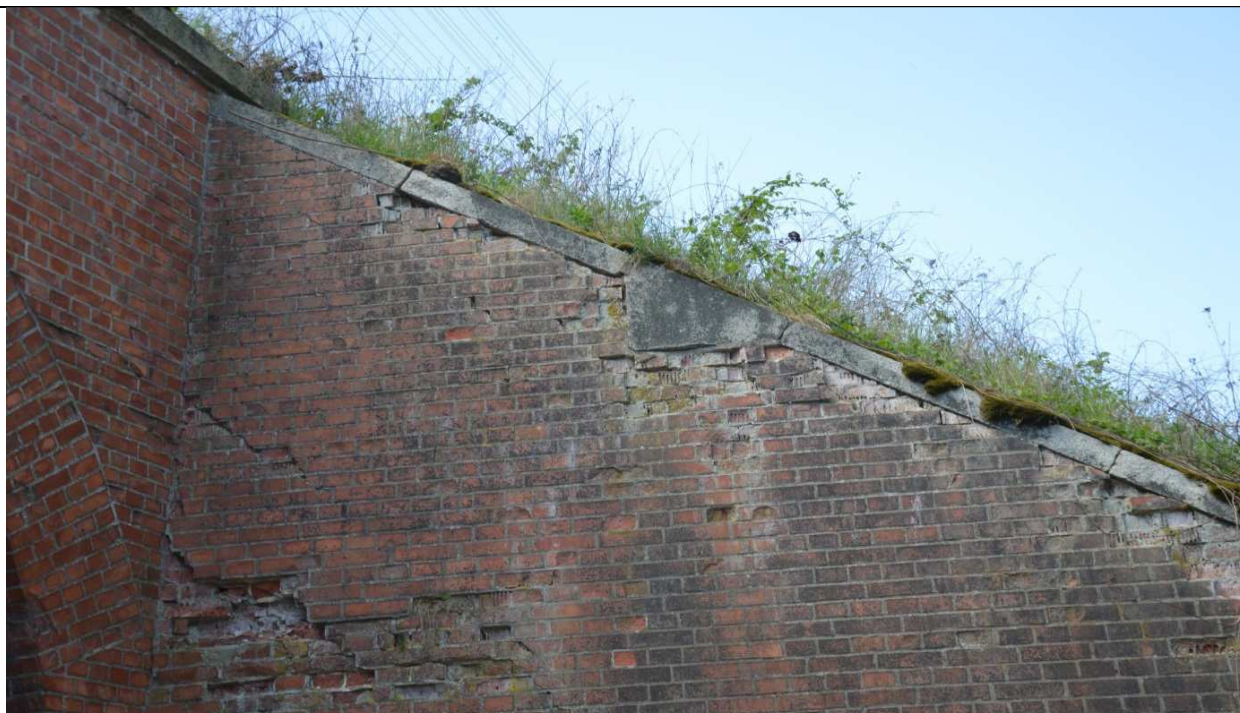
Zdjęcie nr 39. Julianowo, gm. Prabuty, wiadukt sklepiony pod linią kolejową wraz z przejściem dla pieszych. Liczne ubytki w materiale ceglanym na przyczółkach oraz ścianach czołowych, spękania w ścianach bocznych, gzymsy skrzydeł porośnięte roślinnością, brak schodów technicznych do obsługi obiektu.
