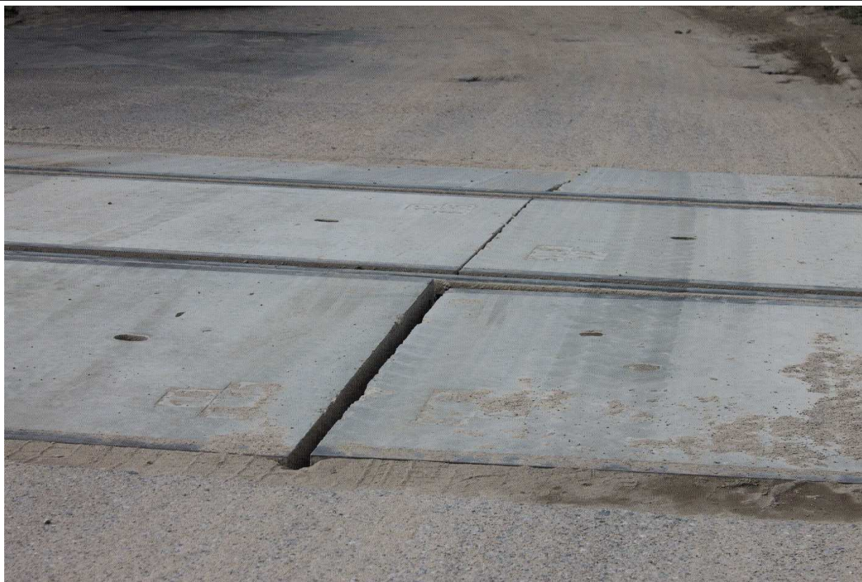
Zdjęcie nr 8. Przejazd kolejowo-drogowy na linii nr 20 w km 1,662 Warszawa Główna Towarowa – Warszawa Praga. Nierówno ułożone płyty przejazdowe na torze 701.
