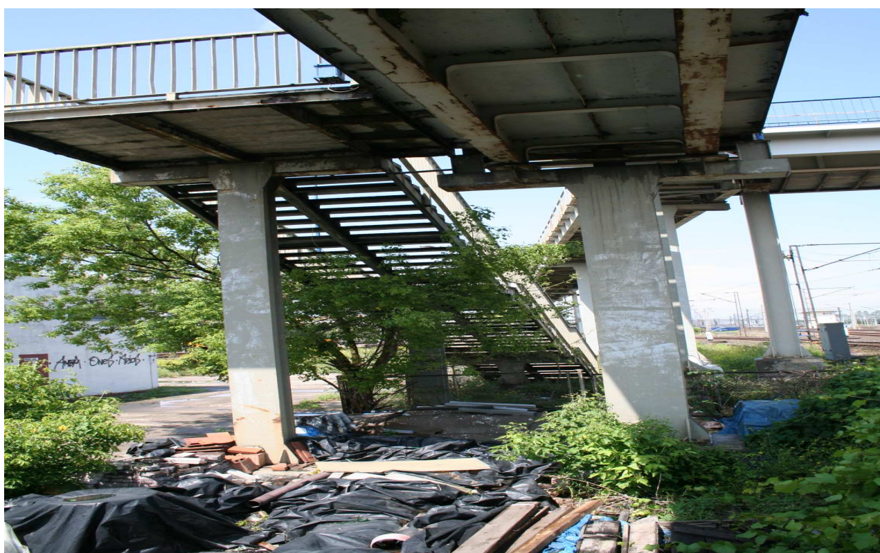
Zdjęcie nr 29. Warszawa, ul Pożarowa, kładka dla pieszych. Uszkodzona powłoka antykorozyjna na dźwigarach głównych, stalowej płycie pomostu, balustradzie oraz schodach stalowych. Zanieczyszczony odpadami budowlanymi teren pod schodami.
