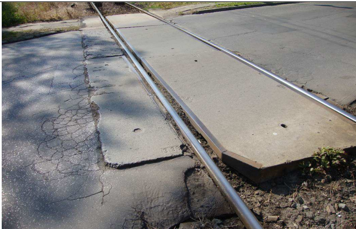
Zdjęcie nr 7. Przejazd kat. C na linii nr 947 w km 1,405. Zły stan skrajnych płyt żelbetowych i uszkodzony asfalt na dojeździe do przejazdu.
