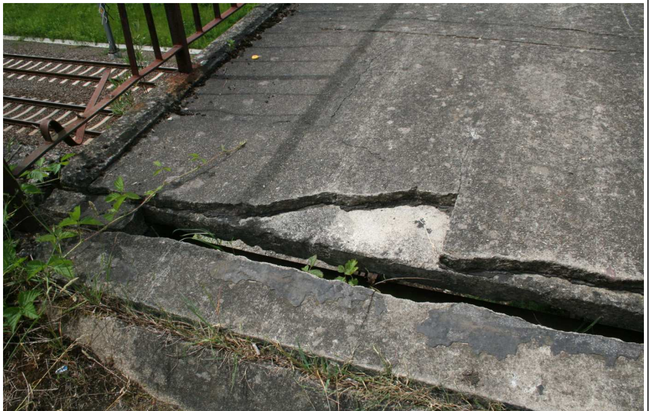
Zdjęcie nr 24. Borów, gm. Prusice kładka nad torami linii Wrocław – Poznań. Brak szczeliniek w balustradzie oraz rozległa korozja powierzchniowa. W betonowej nawierzchni chodnika spękania oraz ubytki nawierzchni betonowej zwłaszcza w strefach dylatacyjnych nad przyczółkami.
