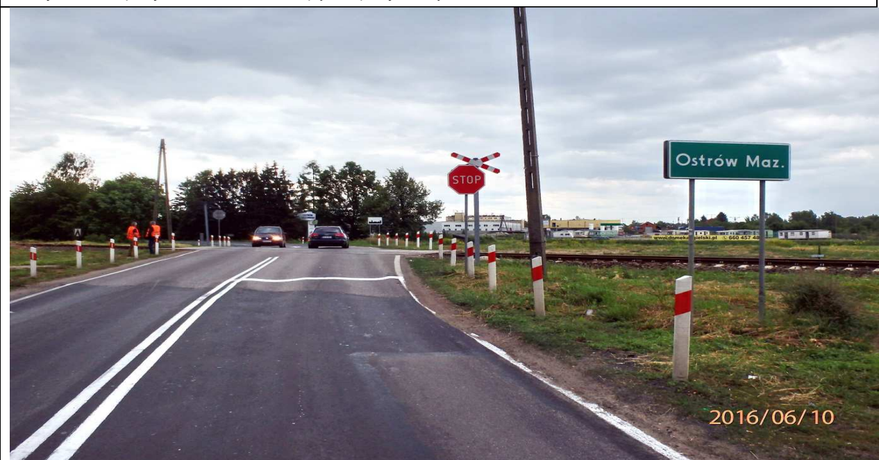
Zdjęcie nr 2. Linia kolejowa nr 034 Ostrołęka – Siedlce, w km 32,901. Koleiny w nawierzchni asfaltowej drogi, na obu pasach ruchu na dojeździe do przejazdu kolejowo-drogowego. Ponadto, po obu stronach drogi ustawione znaki drogowe B-20 „STOP” zasłaniają znaki drogowe G-3 „Krzyż św. Andrzeja”.
