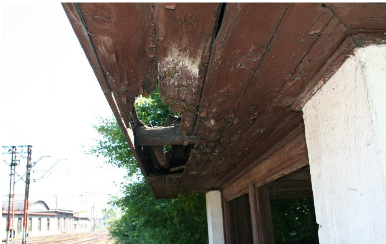
Zdjęcie nr 37. Czechowice – Dziedzice, przejście podziemne pomiędzy ul. Kolejową i ul. Hutniczą. Awaryjny stan stolarki i drewnianego pokrycia dachowego nad wejściem. Zwisające elementy zagrażały bezpieczeństwu pieszych.
