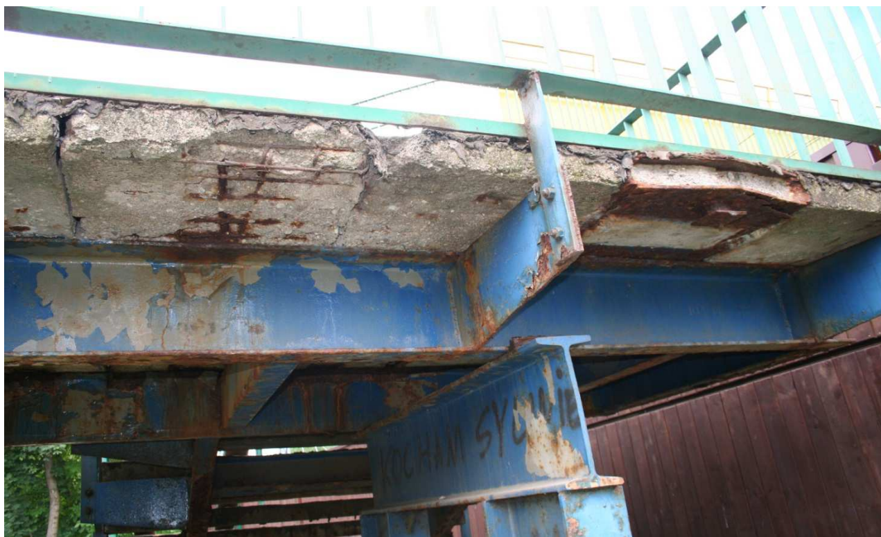
Zdjęcie nr 28. Milanówek, kładka dla pieszych pomiędzy ulicami Krakowską i Warszawską. Na spodzie płyty pomostu korozja odsłoniętego zbrojenia, ubytki betonu, oraz osady, wylugowania i wykwyty. Uszkodzona powłoka antykorozyjna na dźwigarach głównych.
