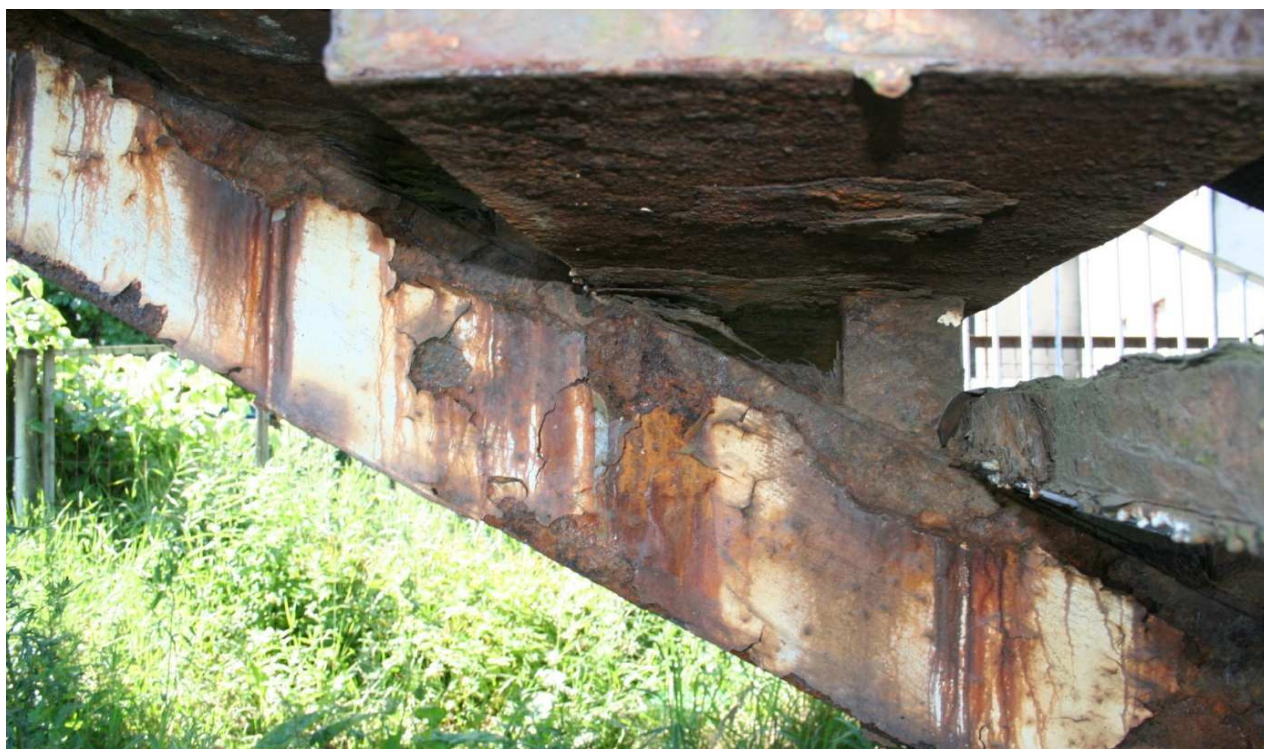
Zdjęcie nr 21. Katowice, kładka dla pieszych w ciągu ul. Paderewskiego, linia nr 001. Zły stan techniczny stalowych belek nośnych oraz spodniej powierzchni stopni i spoczników schodów kładki.
