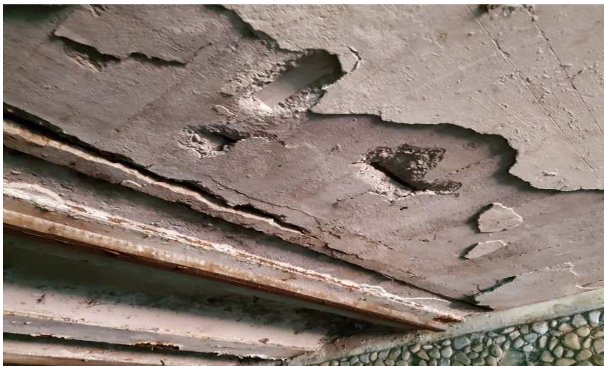
Zdjęcie nr 34. Katowice, przejście podziemne na linii nr 1, km 312,936. Ubytki tynku i betonu na sklepieniu.
