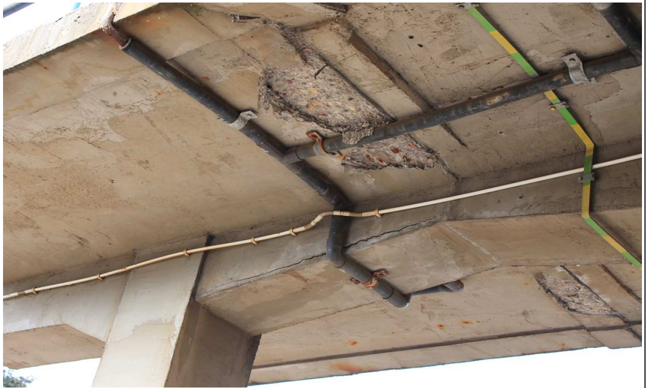
Zdjęcie nr 23. Ożarów Mazowiecki, kładka dla pieszych w km 15,538, na linii kolejowej nr 003. Wykruszenia, pęknięcia i uszkodzenia betonu od spodu pomostu.
