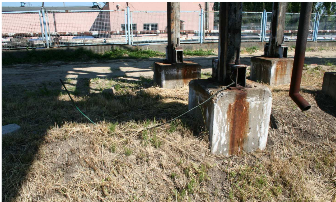
Zdjęcie nr 30. Kładka w Chorzowie ul. Maronia. Zerwana linka uszynienia (zagrożenie porażenia prądem elektrycznym). Korozja stalowych słupów. Na fundamentach podpór ubytki betonu.
